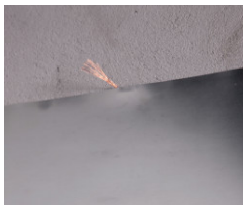
Elektrisk ledning, der tidligere er forbundet med armeringsjern
